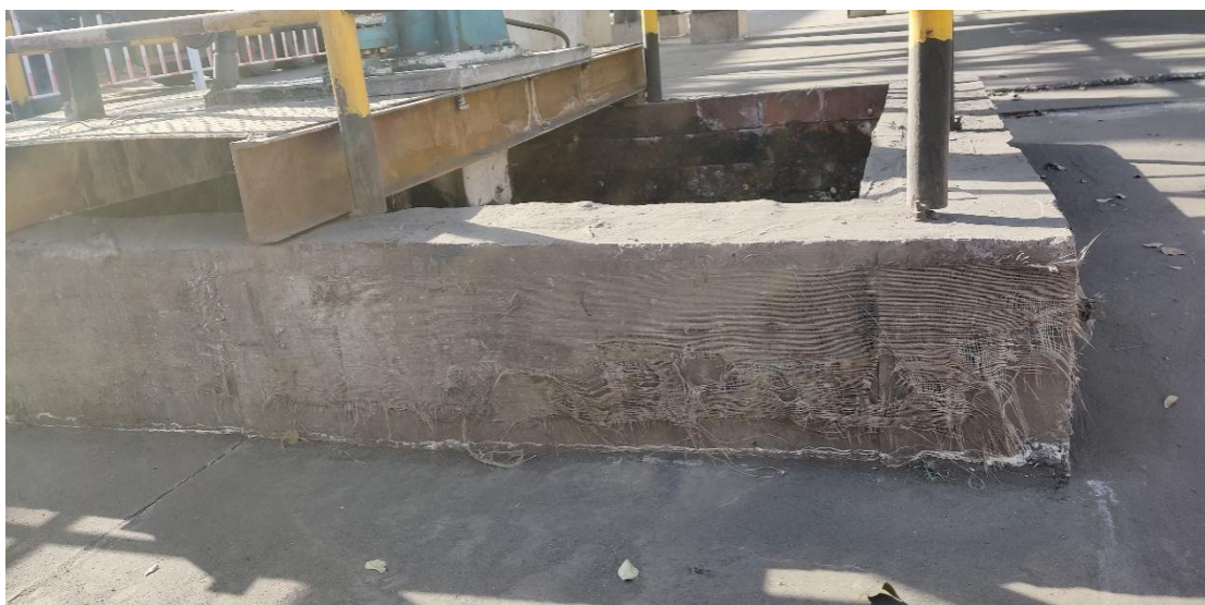
(装车区域应急收集池)
