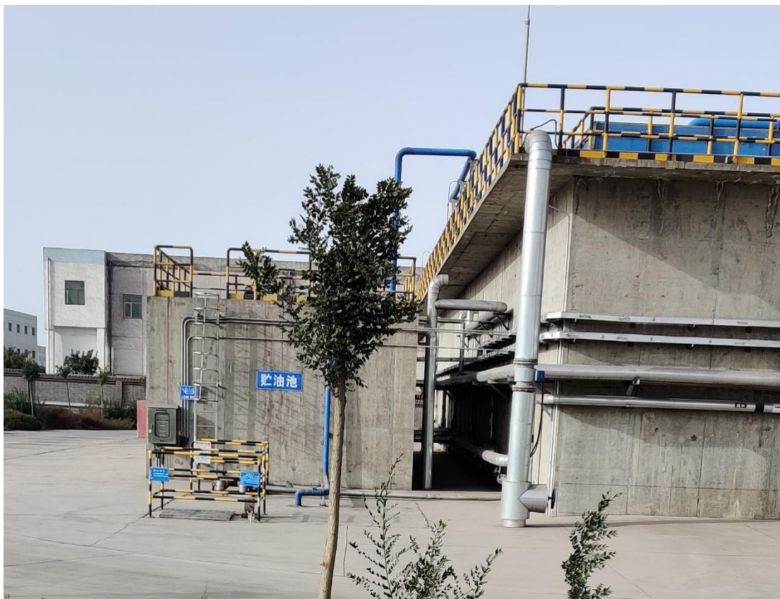
图 3-28 焦化厂酚氰废水处理站内主要设备
