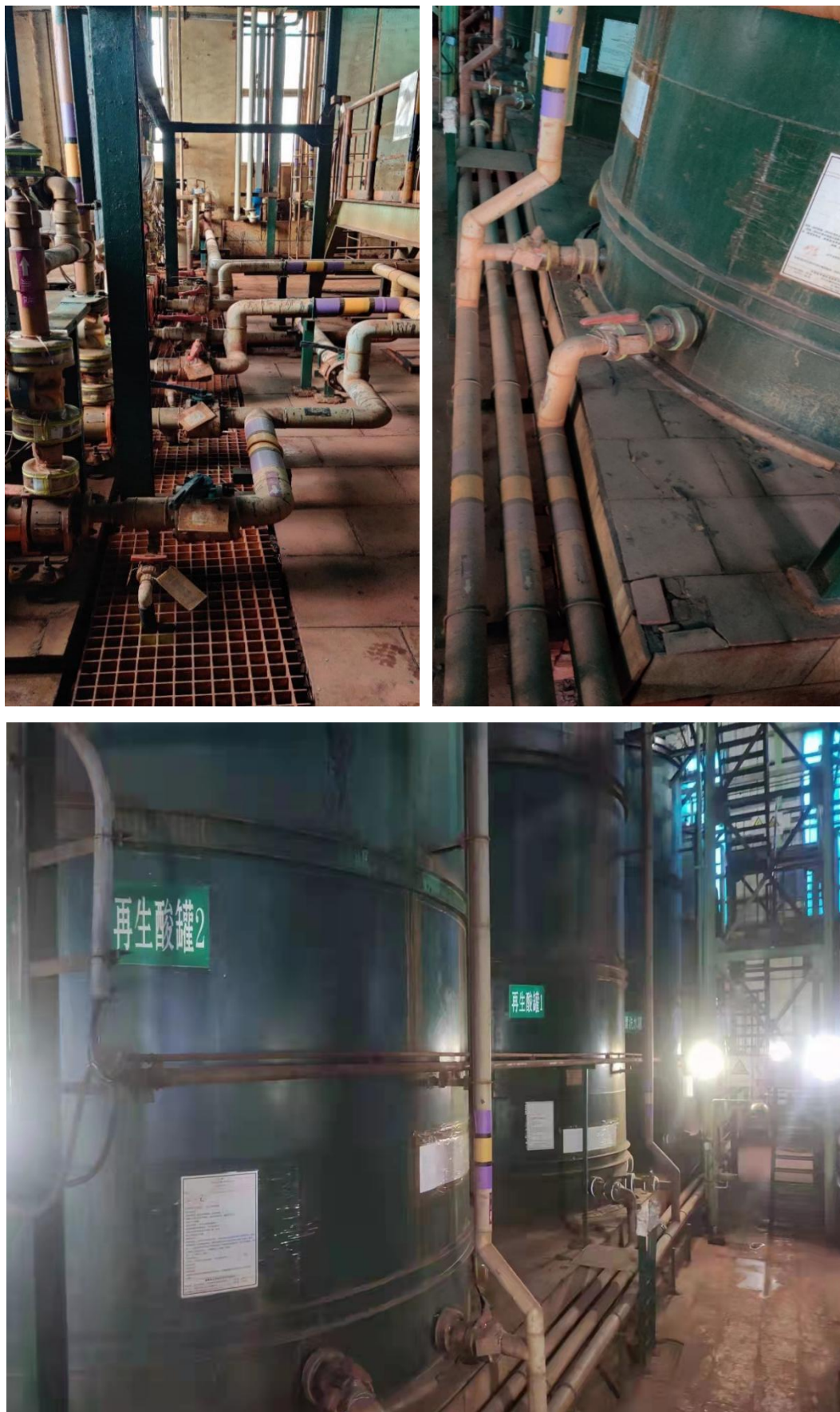
(碳钢薄板厂储酸站)
