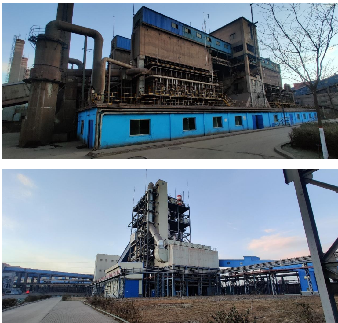
图 3-23 选矿厂厂内主要设备
