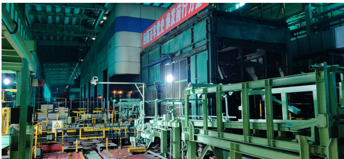
碳钢薄板厂部分生产设备
