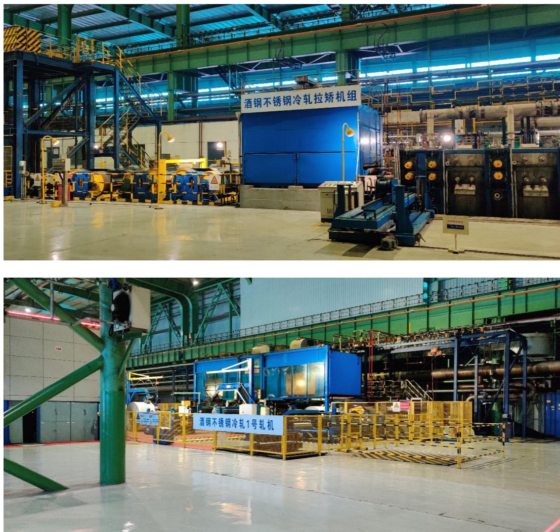
图 3-27 不锈钢厂厂内主要设备
