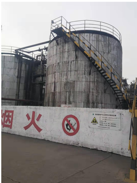
(焦化厂焦油储罐)
