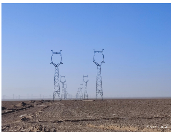
12月线路区临时堆渣未整治, 施工道路未整治, 计划2023年进行整改
