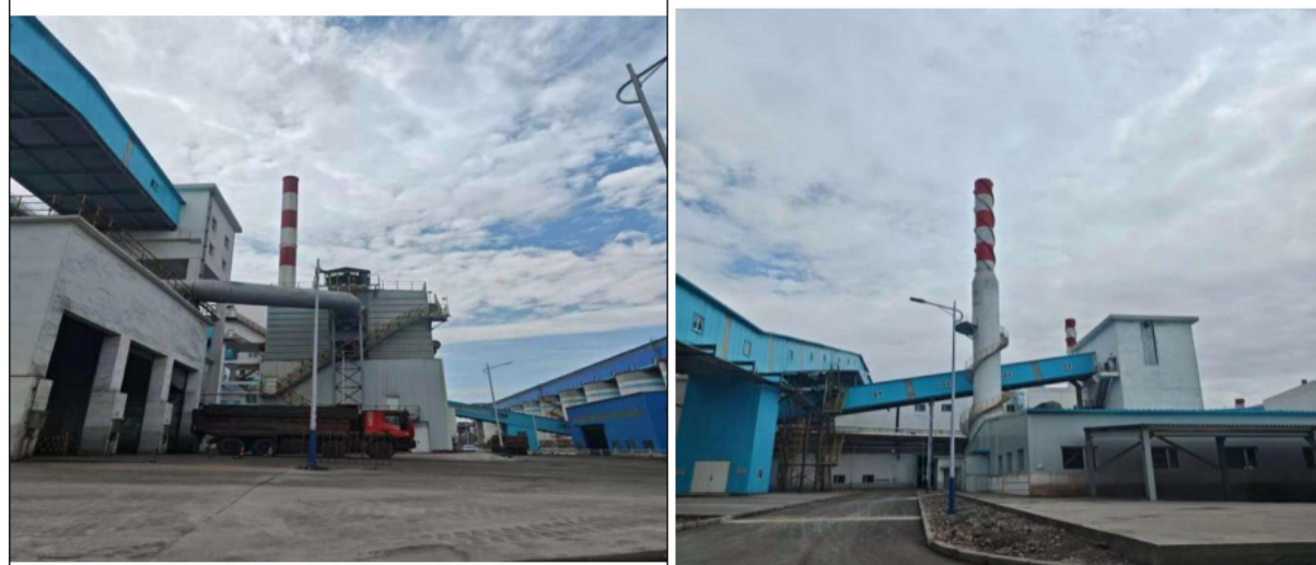
转运站除尘系统
