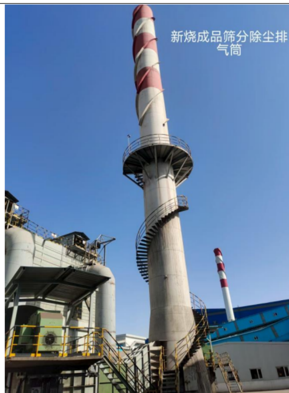
成品筛分除尘系统排气筒
