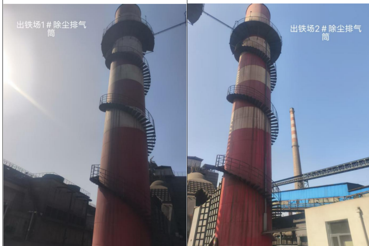
新3#高炉出铁场除尘系统排气筒
